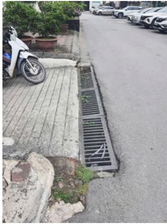
Cổng hộp kín 400x600mm thoát nước mưa
