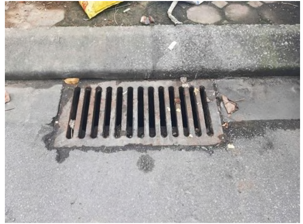
Nắp hồ ga cổng thoát nước mưa
